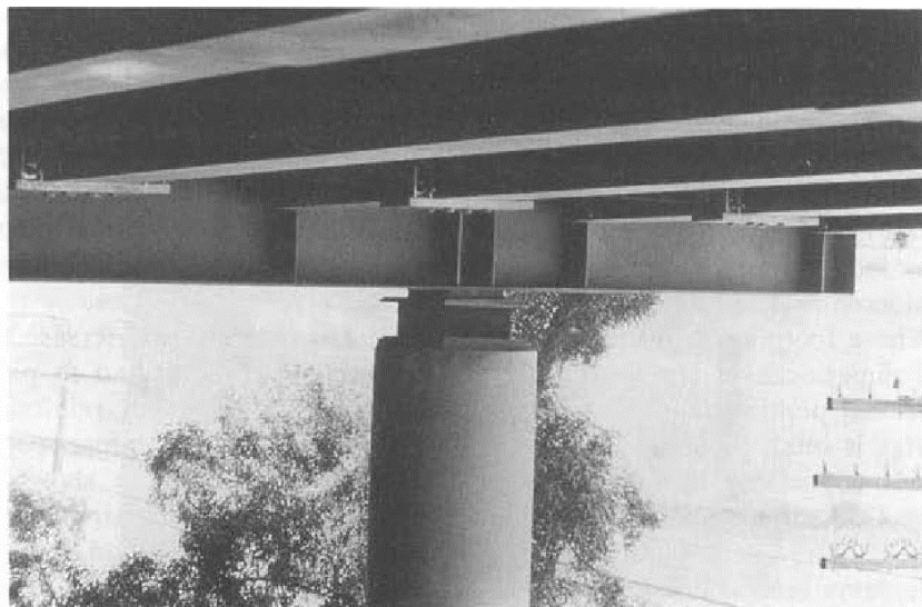
Fig. 2-6 Pajisje izoluese të vendosura në Sierra Point para tërmetit Loma Prieta 1989
