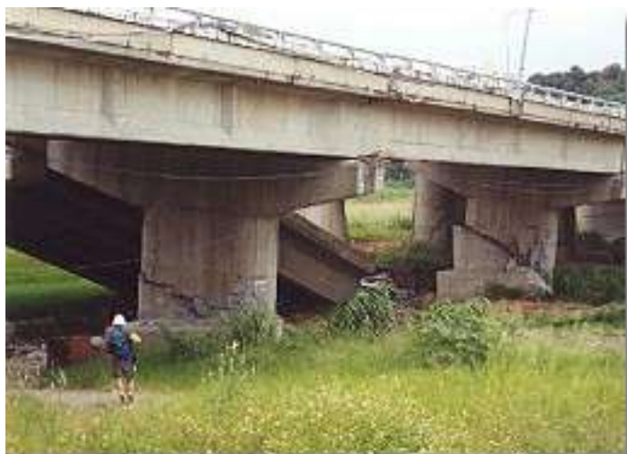
Fig. 1-5 Dëmtim nga forca prerëse. Viadukti në Avenun Gothic (Tërmeti Chi-Chi 1999 , Taivan internet)
