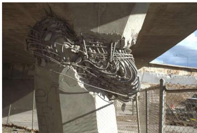
Fig. 1-4 Çernierë plastike nga përkulja e forca prerëse duke vepruar në mënyrë ciklike. Viadukti në Avenun Gothic (Tërmeti Northridge Kalifornia 1994 internet FEMA )
