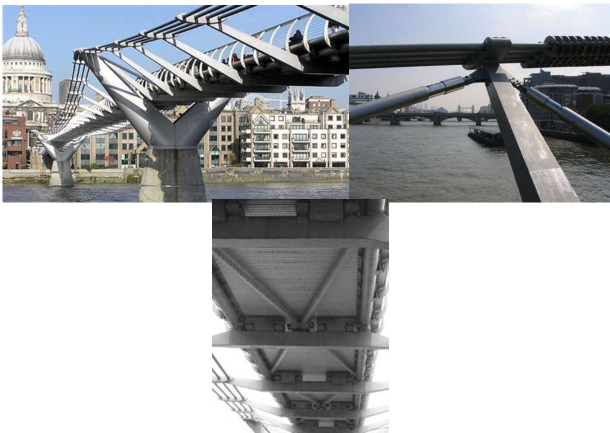
Fig. 3.12 Millennium footbridge, Arup & Norman Foster, 2000; ura më e shtrenjtë në dekadat e fundit: 37700 \text{ €/m}^2 [26].
