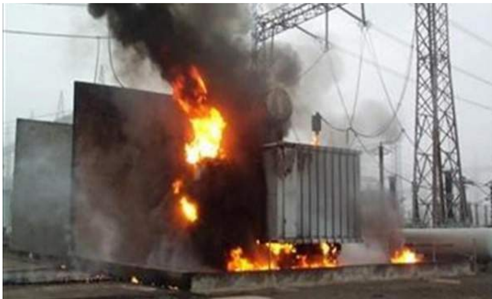
Fig.3.3 Shpërthimi i një transformatori të sistemit të transmetimit
