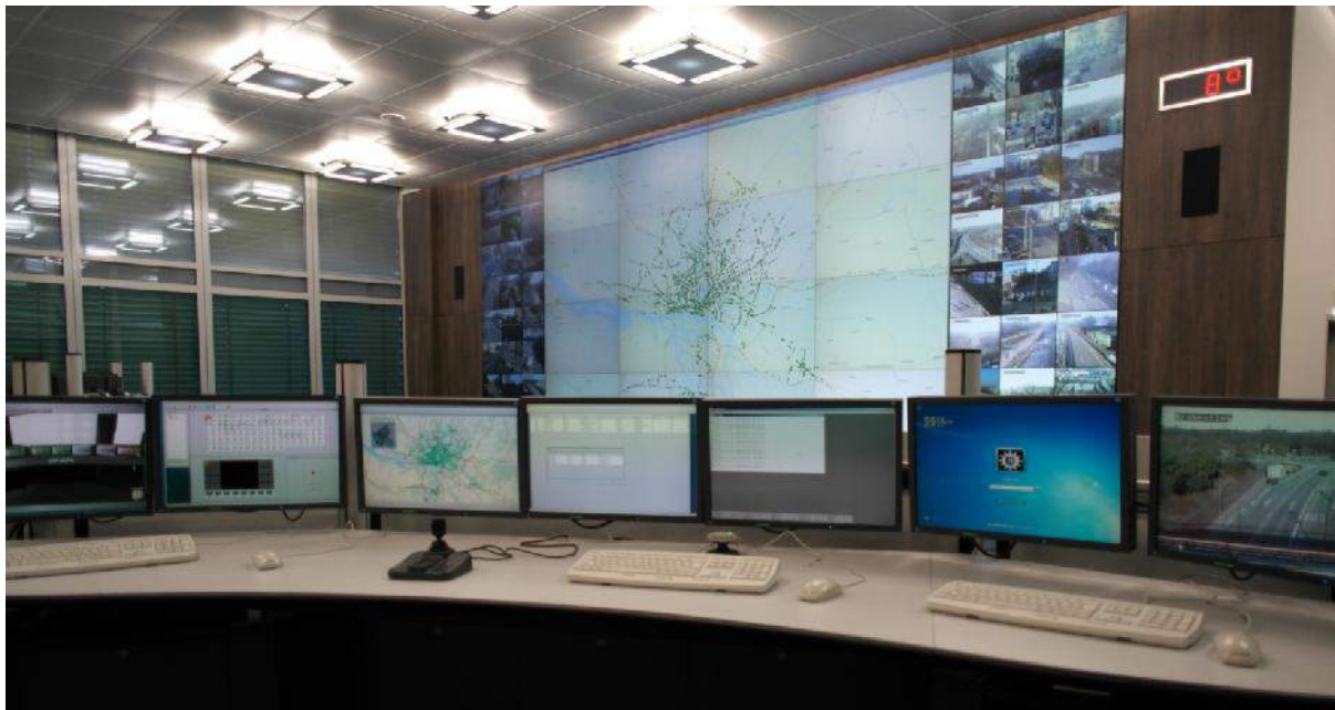
Figura 83: Qendra Kombëtare e Kontrollit dhe Menaxhimit të Trafikut
