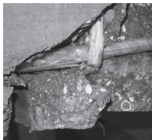
Fig. 2.9 Shkatërrimi i shufrave GFRP
