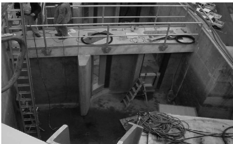
Fig. 1.8 Portë betoni dige e armuar me GFRP (Washington, USA)
