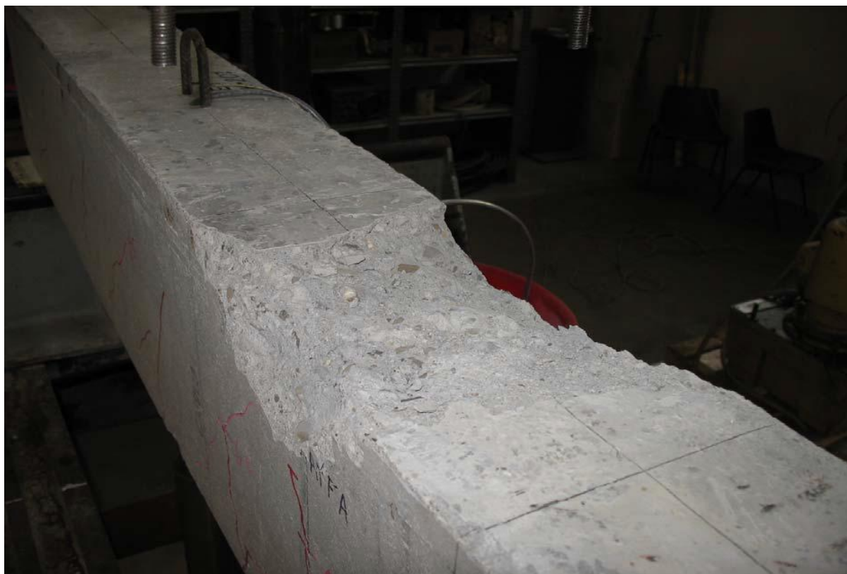
Fig. 6.18 Trau T1- detaj i shkatërrimit të traut në zonën e shtypur të betonit
