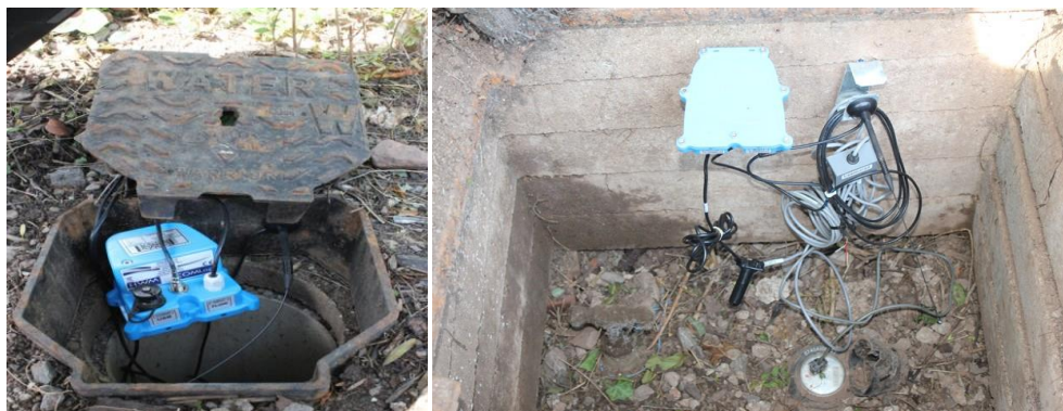
Figura 6.4 Instalimi i Data logger-ve, Qyteti i Lipjanit
