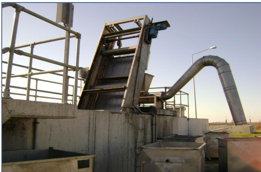
Figure 2.4 Grilat në njësinë e trajtimit paraprak në Impiantin e Kavajës
