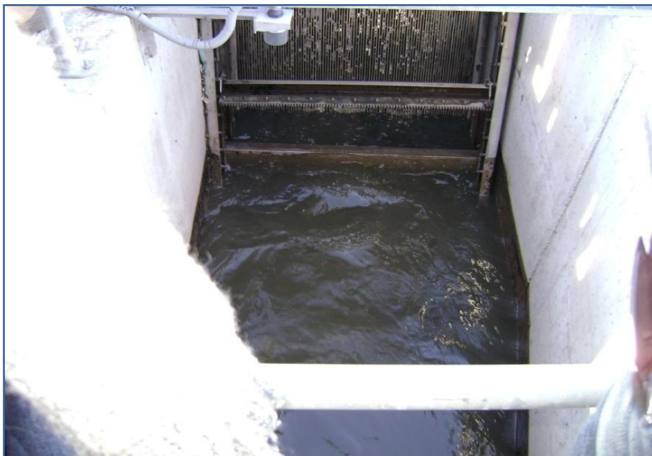
Figure 2.3 Dhoma e hyrjes së ujërave të ndotura në Impiantin e Kavajës
