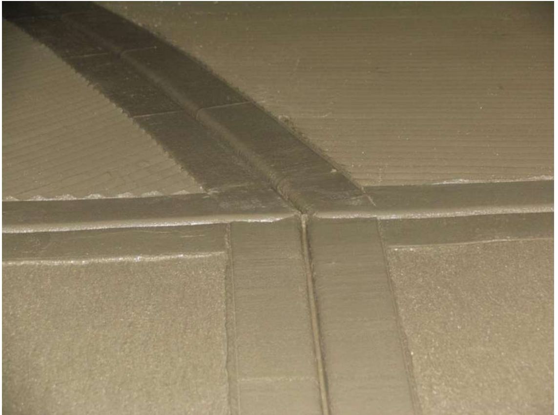
Foto 11 Fuga të shtresës përfundimtare
