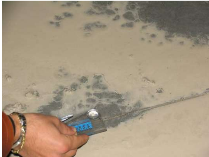
Foto 9 Matja e gjerësisë së fugës
