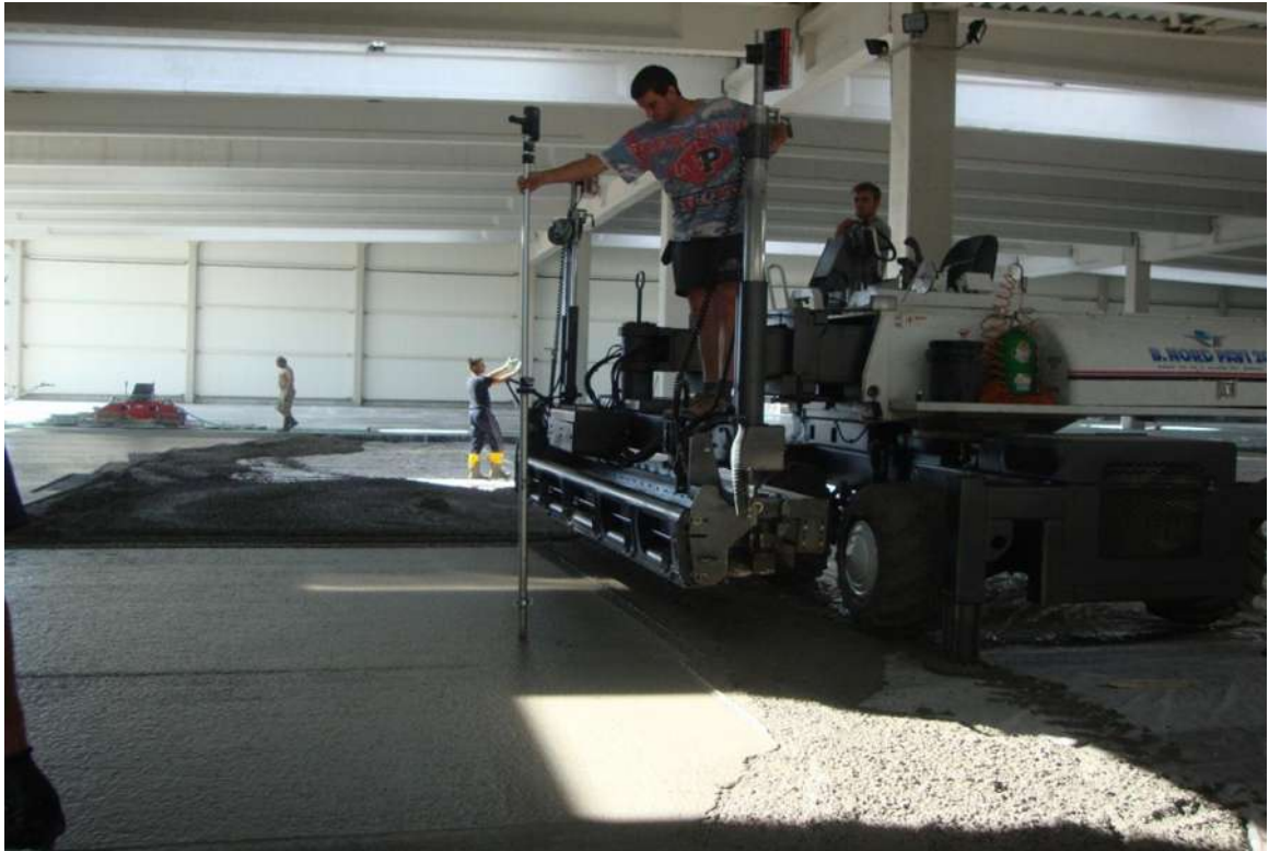
Foto 5 Kontrolli i trashësisë së dyshemesë
