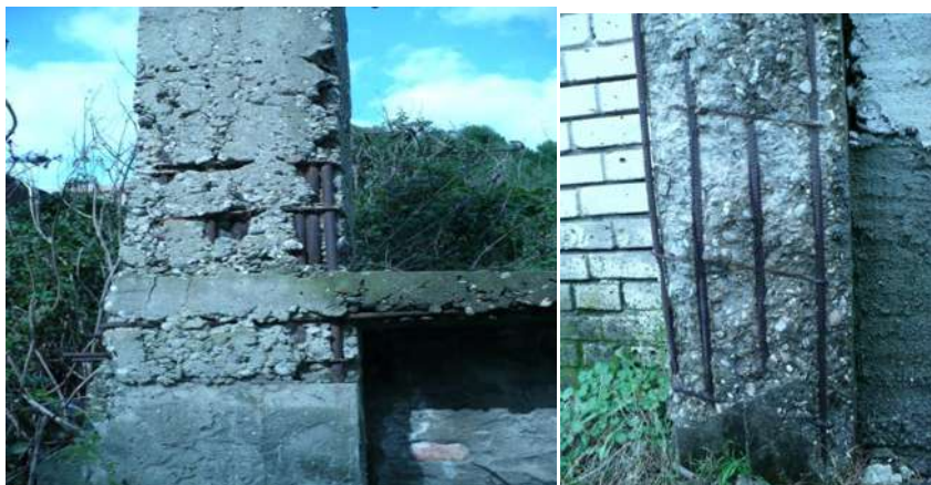
Figura 2.1.5.1, 2.1.5.2: Shembuj të ngjeshjes jo të mirë të betonit në strukturën e betonit, ish Pishina Durres
