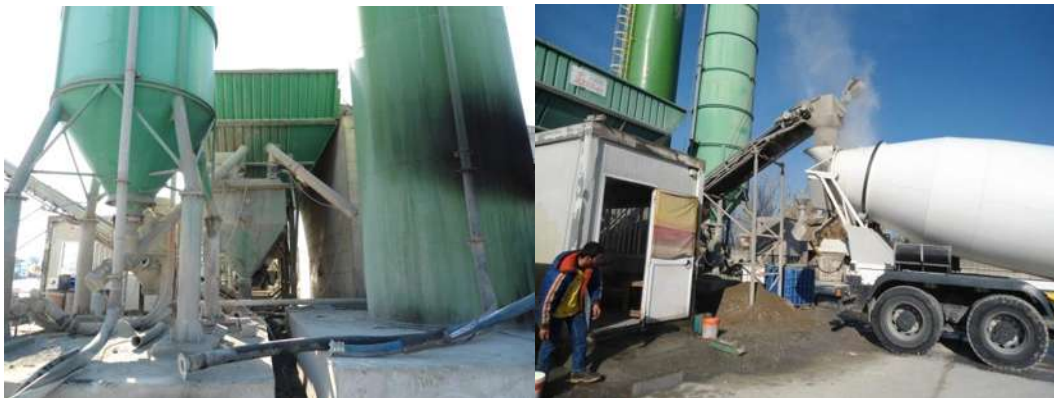
Figura 2.1.2.1, 2.1.2.2: Fabrikë e prodhimit të betonit
