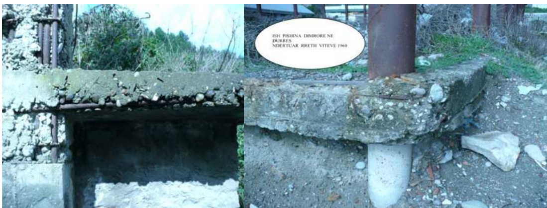
Figura 1.2.1.4: Shembuj të defekteve në ngjeshjen e betonit, në ish pishinën dimërore në Durrës
