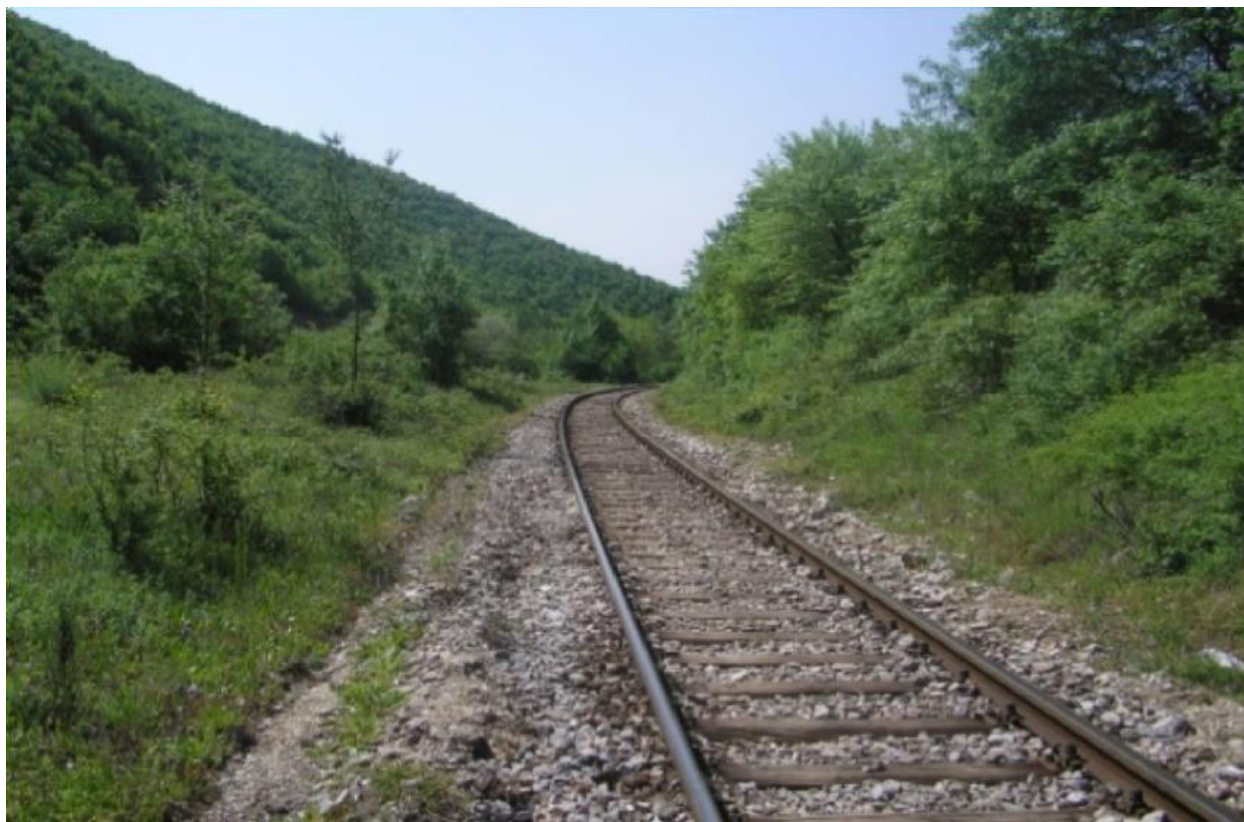
Figura9: Gjendja e infrastrukturës në Mitrovicë
