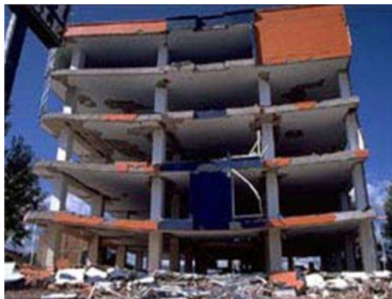
Figura II: Strukturë e shkatërruar në Gölcük
