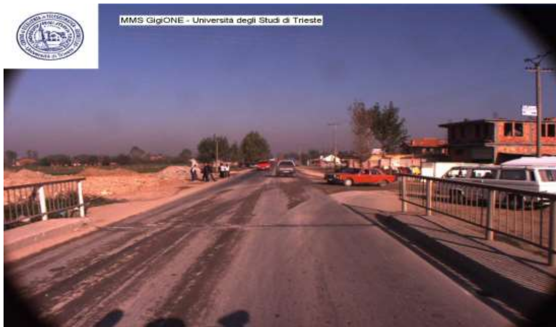
Figura 5.5. (foto 1348 projekti “SISA” Survey and Information Systems of Adriatic roads) 9 km 486 m dalje nga ura e lumit të Zallherrit, Kufiri Tirane – Krujë.) [44] Këtu fillon segmenti në shqyrtim dhe siç shihet rruga nuk ka sinjalistikë horizontale që nga Kamza.
