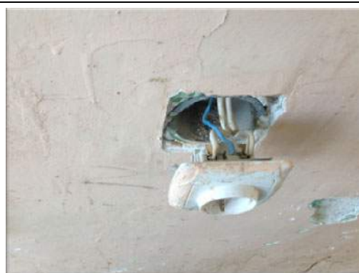
Figure 6: Priza elektrike e murit
