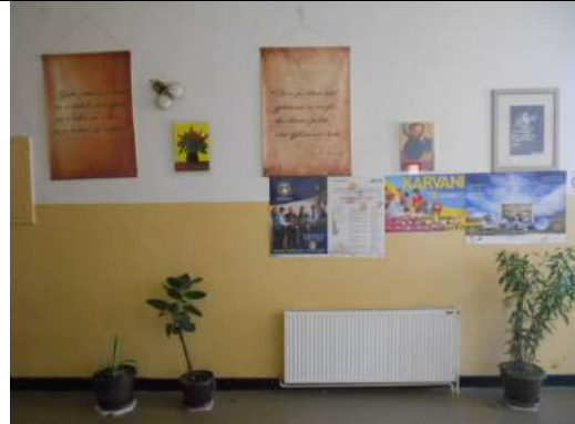
Figure 4: Radiatorët e rinj për ngrohje
