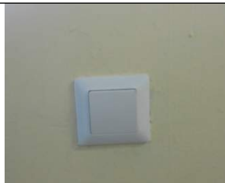
Figure 6: Ndërprerësi i ri elektrik
