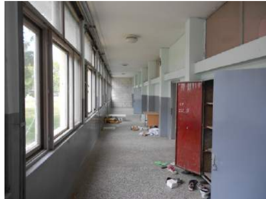
Figure 14 Gjendja ekzistuese para masave të EE
