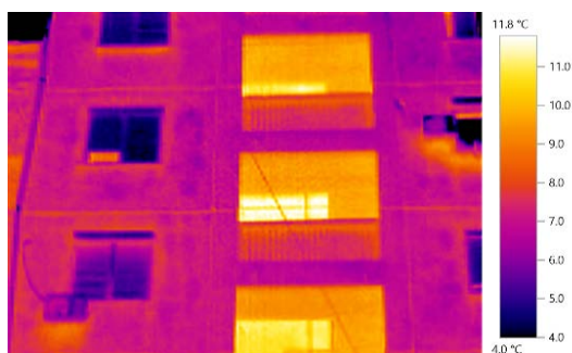
fig.5humbjet e nxehtësisë përmes mureve pa izolim termik në kafazin e shkallës. Matje 28.12.2013 ora 20.04.
