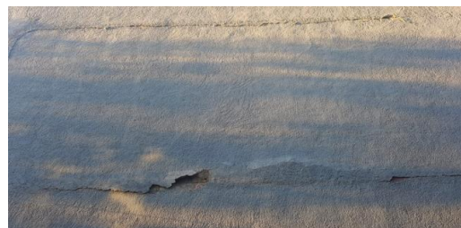
Fig. 18. Shkëputje, çarje murature mbushëse, thyrje të tullës. Ndërtesë 5 KT, rame b/a, Tiranë, Ndërtesa e FIN
