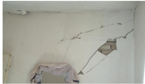
Fig. 17. Çarje në murature tulle. Ndërtesë 1KT muraturë tulle. Fshat para Tiranës
