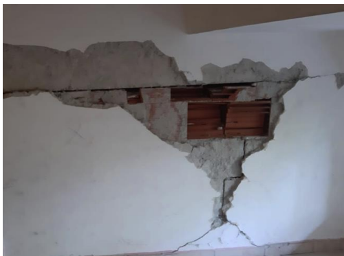
Fig. 16. Shkëputje, çarje murature mbushëse, thyrje të tullës. Ndërtesë 5 KT, rame b/a, Durrës, Plazh
