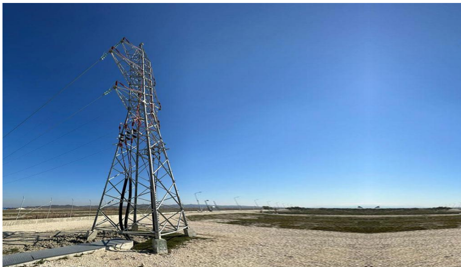
Figura 4.42 Linja elektrike ajrore 35kV
