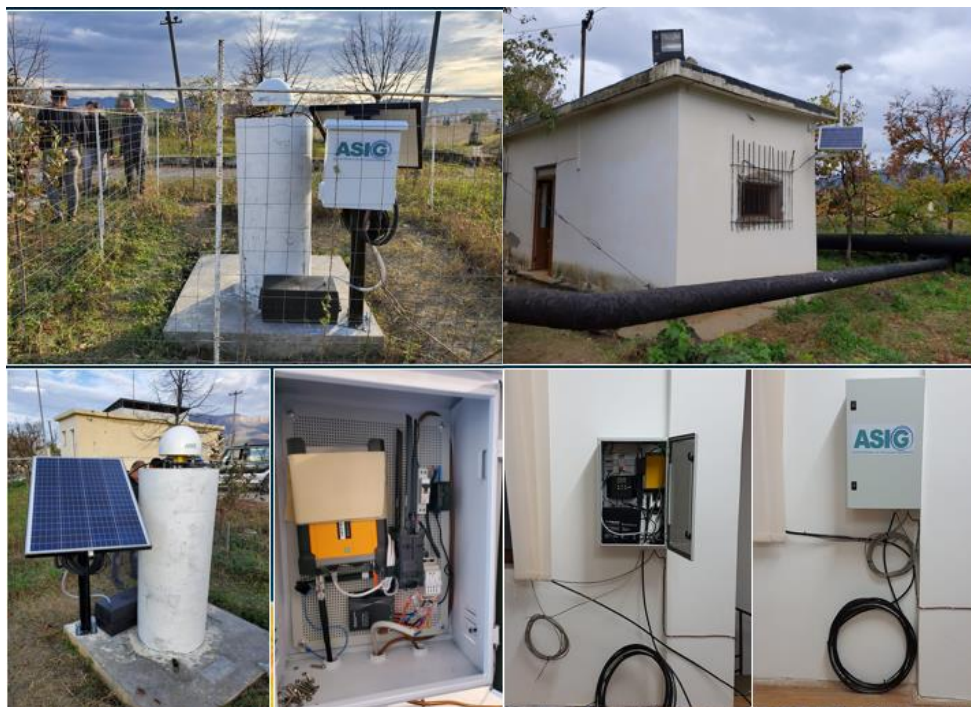
Figura 7 - Stacione të rrjetit ALBCORS ndërtuar në bllok betoni dhe antenë
